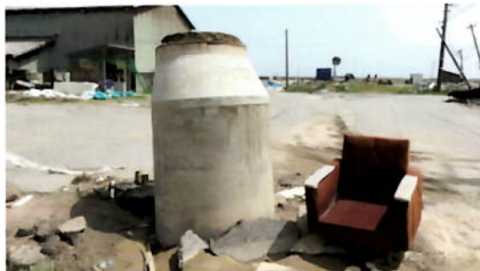
地震の影響で隆起したマンホール
